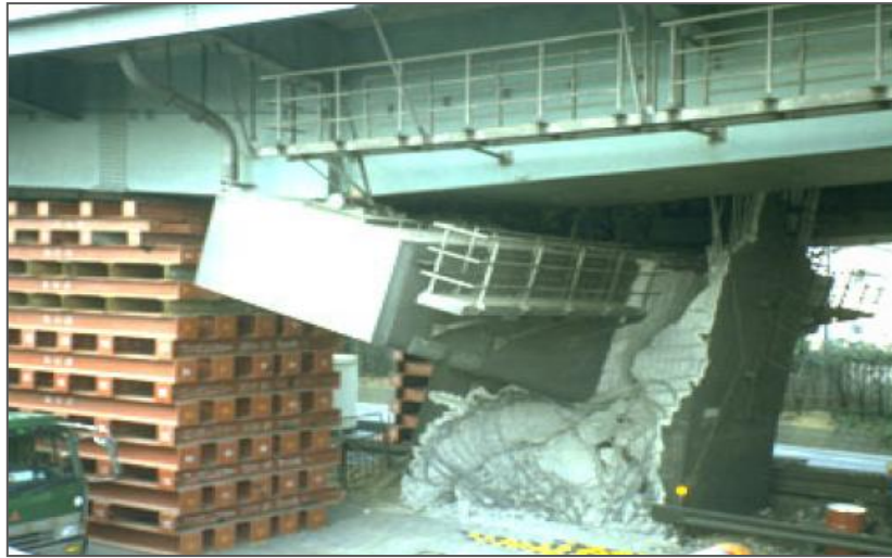
Figure I.8. Ruine à l'effort tranchant d'une pile de pont en béton armé "Kobe en 1995" [5]
