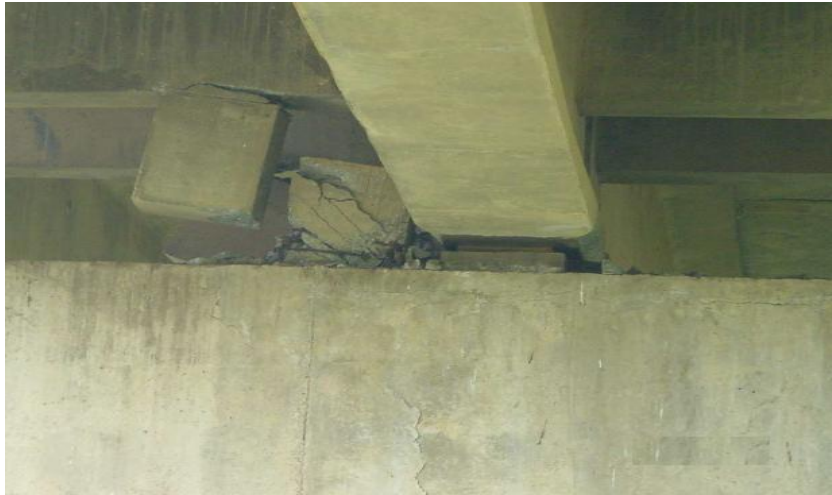
Figure I.10. Appui longitudinal écrasé, sur la culée d'un pont-poutre, Boumerdès 2003 [13]
