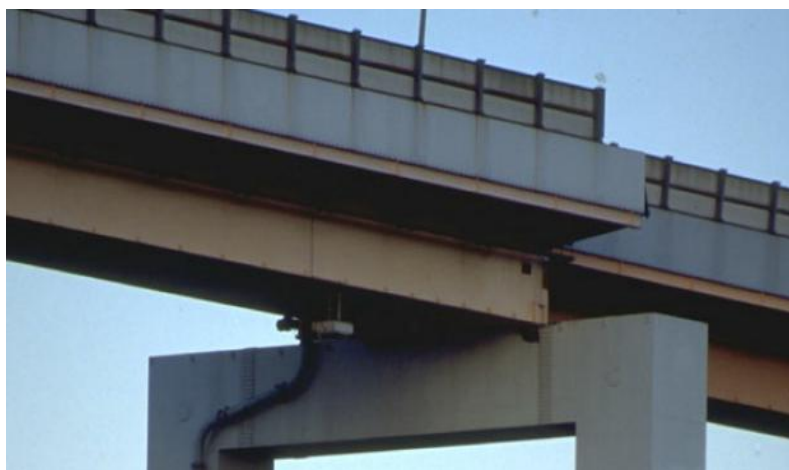
Figure I.5. Déplacement latéral du tablier et chute des appuis sur la palée d'un pilier à Kobe 1995 [5]
