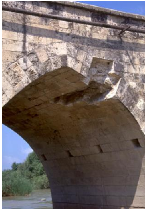
Figure I.9. Pont-arc en pierres naturelles endommagé "Turquie 1998" [5]
