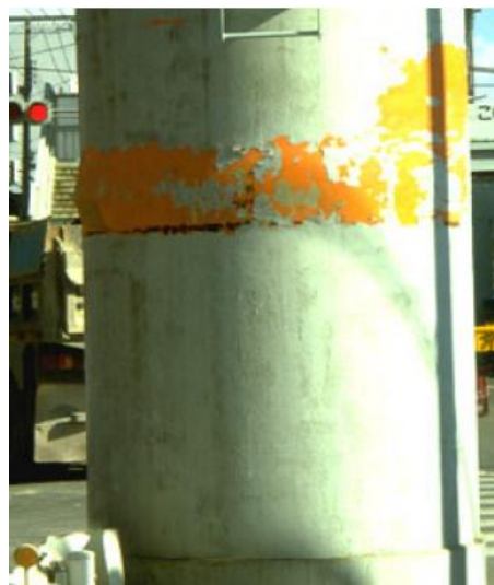
Figure I.7. Voilement d'une pile métallique ronde "Kobe en 1995" [5]
