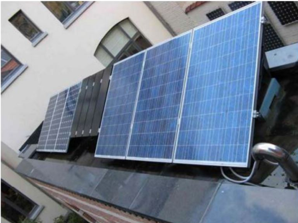
FIGURE 1.3 – Générateur photovoltaïque formé par un ensemble de panneaux solaire
