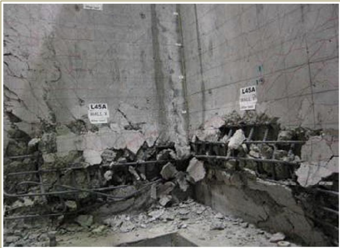
Figure I.8 Type de fissuration du voile L45A (d'après [34]).
