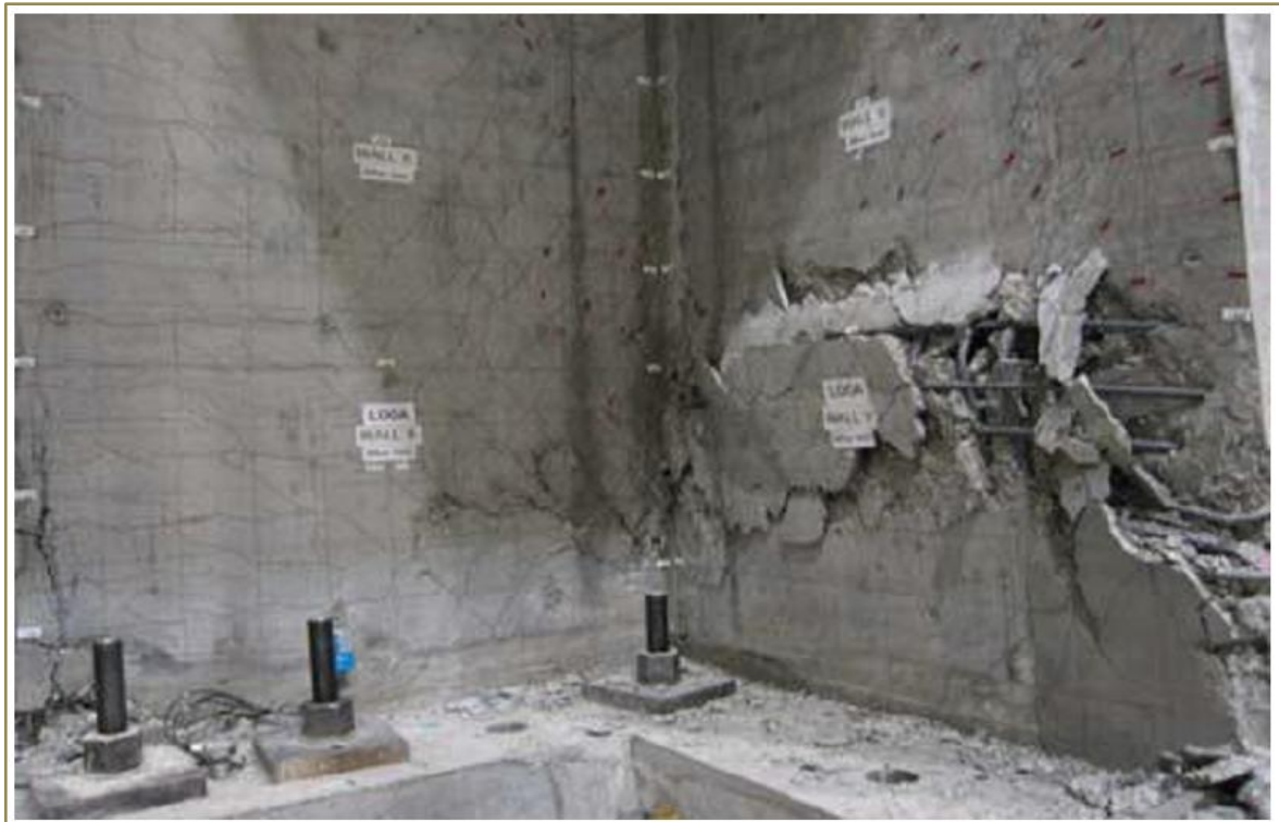
Figure I.7 Type de fissuration du voile L00A (d'après [34])
