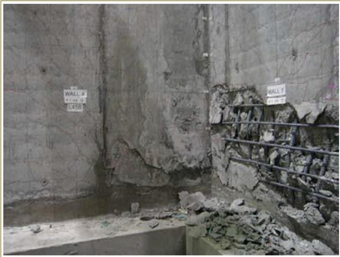
Figure I.10 Type de fissuration du voile L45B (d'après [34]).
