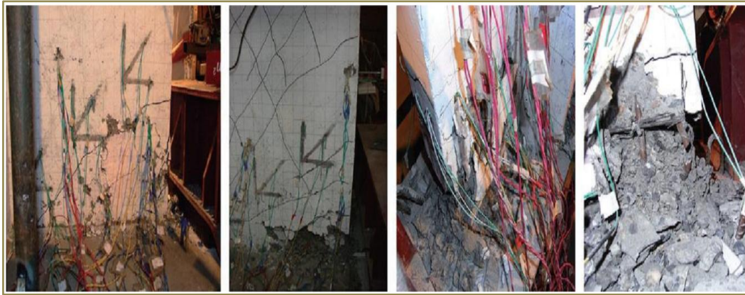
Figure I.12 Distribution des fissures du type de voile DL2 (rapport de 2.8)
