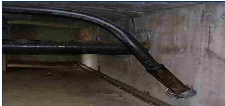
Figure II.7. Rupture du câble par corrosion
