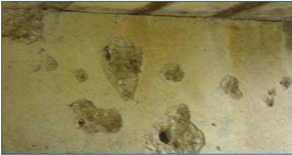
Figure II.2. Eclatement localisé du béton
