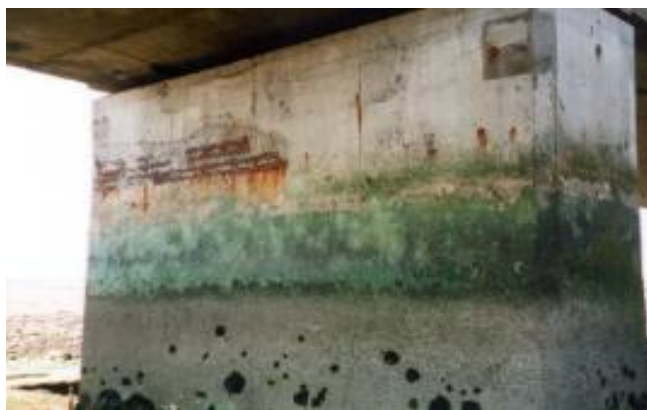
Figure IV.1. Pont en béton armé dégradé
