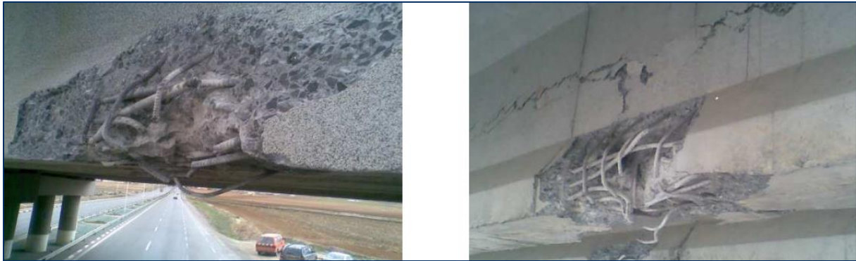
Figure II.3. Dégradations causées par le choc
