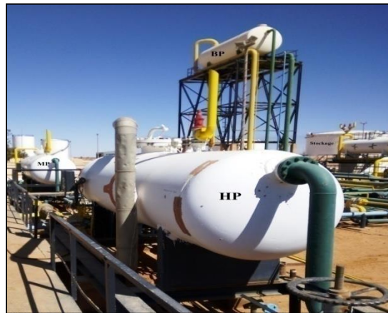
Figure I.2. 4: Batterie de séparation de pétrole brut
