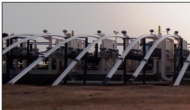
Figure I.2. 2: Liaisons de collecte de pétrole brut dans la région de STAH
