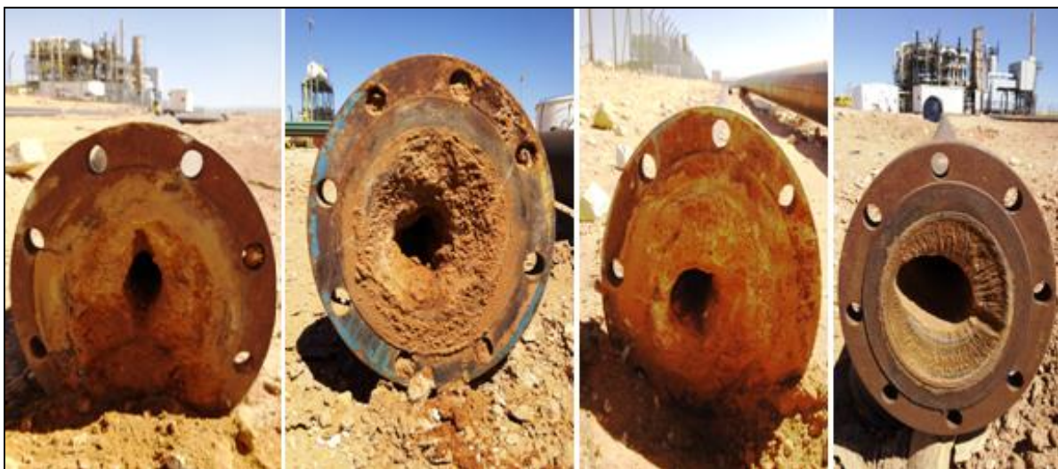
Figure I.2. 5: Dépôt de sulfate de baryum au niveau de l'unité de production STA
