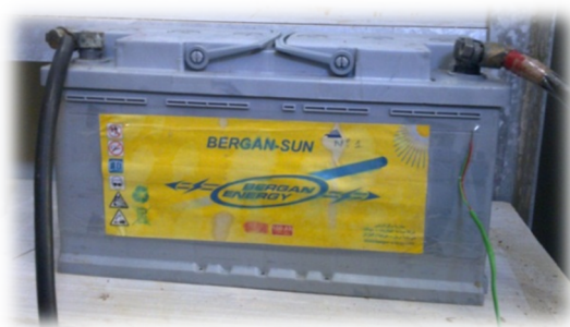
Figure V.5. Batterie stationnaire BERGAN-SUN
