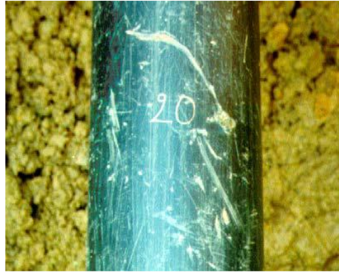
Figure I.7 : Défectuosité du revêtement ( 15 \times 20 \text{ mm} ) sur la génératrice supérieure de la canalisation, la dimension du trou dans le revêtement est de quelques \text{mm}^2 [1]
