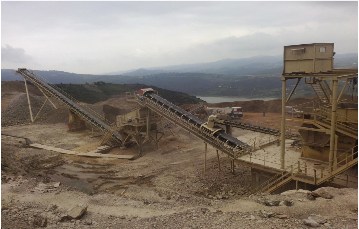
Figure VII.1 : station de concassage primaire
