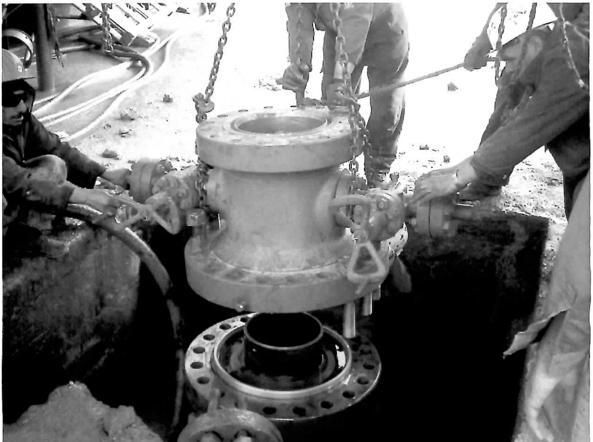
Fig 14 : Montage tête de puits
