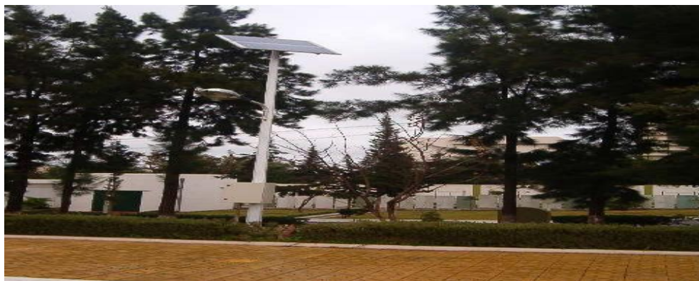
Figure VII.12 : Pilonne d'éclairage solaire type (UDES).
