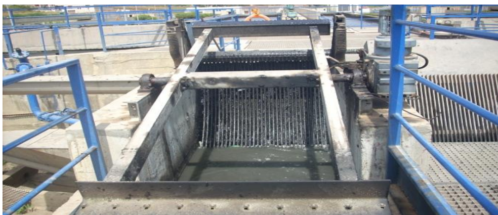
Figure V.6:Photo du dégrilleur [STEP Boumerdes]
