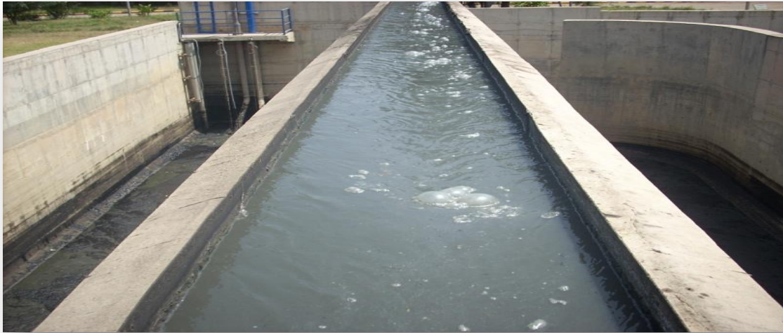
Figure V.5 : Photo de l'arrivée de l'eau brute [STEP Boumerdes]
