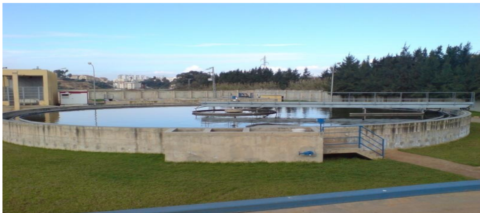
Figure V.9: Décanteur secondaire – clarificateur [STEP Boumerdes]
