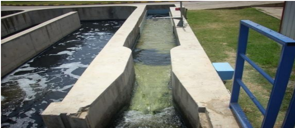
Figure V.10: Photo de l'ouvrage de désinfection [STEP Boumerdes]
