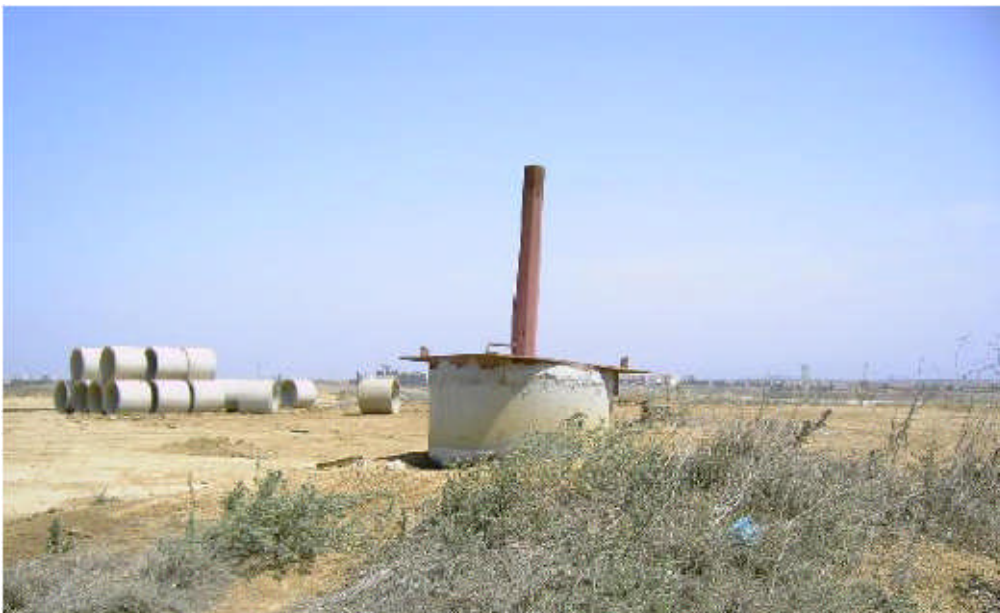
Figure IV.6 : système de récupération des biogaz (sans traitement).
