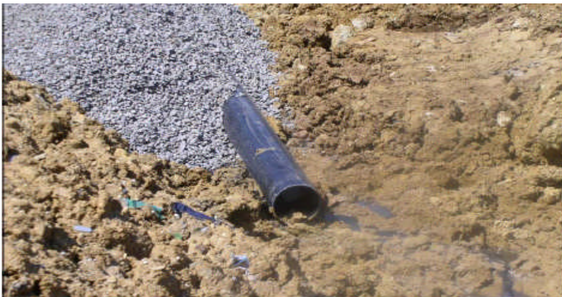
Figure IV.5 : Conduite de drainage des lixiviats.
