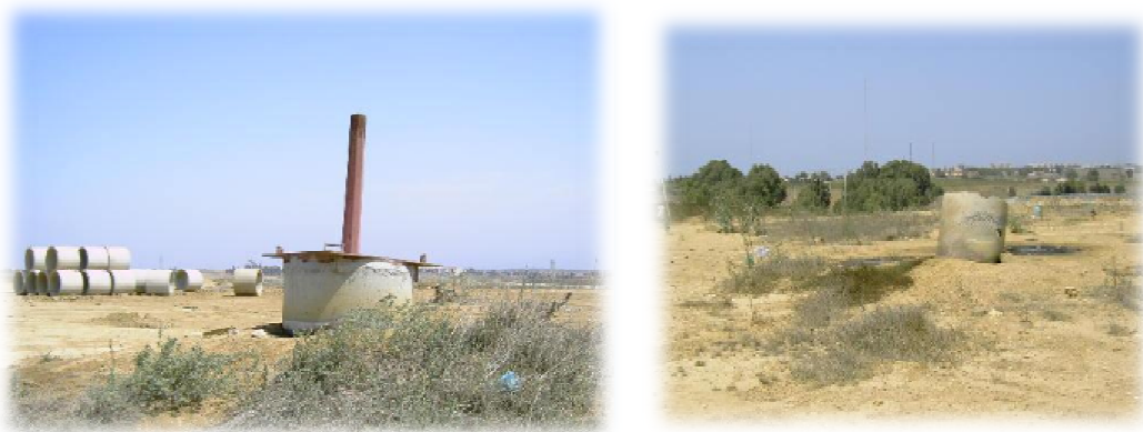
Figure 19: Système de récupération de BIOGAZ sans traitement, Ouled Fayet.
