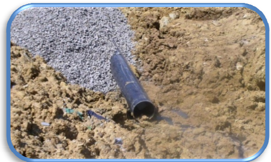
Figure 15: Conduite de drainage des Lixiviats.
