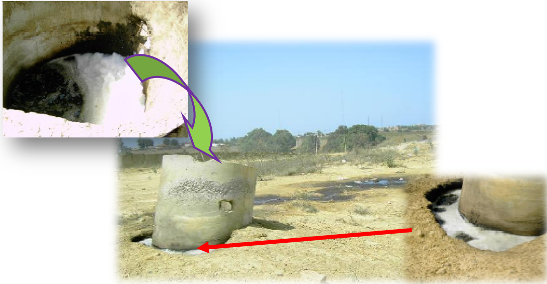
Figure 20: Refoulement de lixiviats vers l'extérieur au niveau du cheminé de récupération des Biogaz du Casier N° 1, Ouled Fayet.
