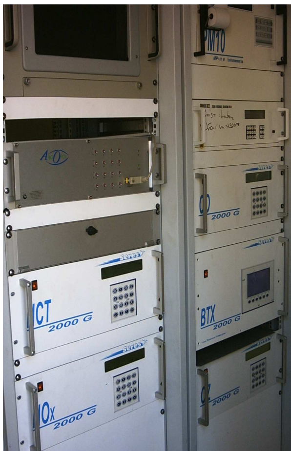
Photo. n°3 : Baie d'Analyse de la station de surveillance de BENA KNOUN
