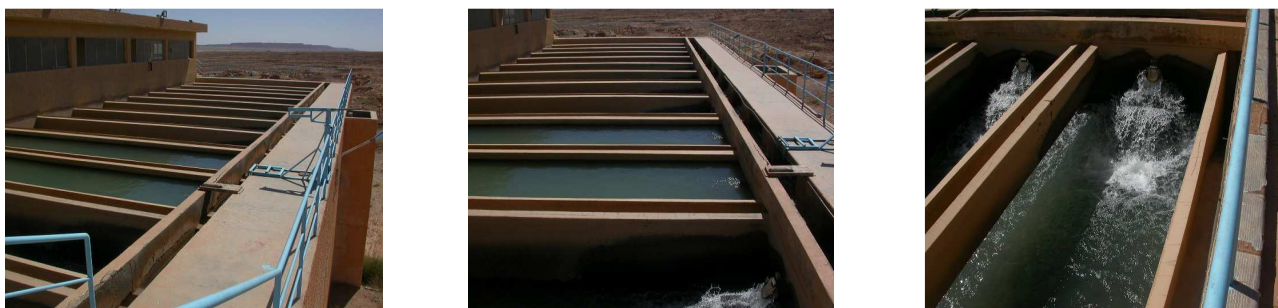
Figure 3.4: Filtre à sable filtration lente au niveau du Barrage DT. Mars 2008
