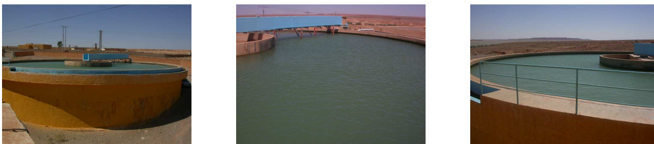
Figure 3.3: Décanteur circulaire au niveau du Barrage DT. Mars 2008
