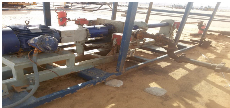
FIGURE 7.6 – La pompe installée au champs HGA
