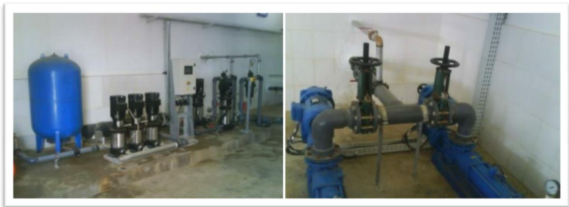
Figure IV.15 : Systeme de pompage pour l'aspiration des boues en excès.[9]
