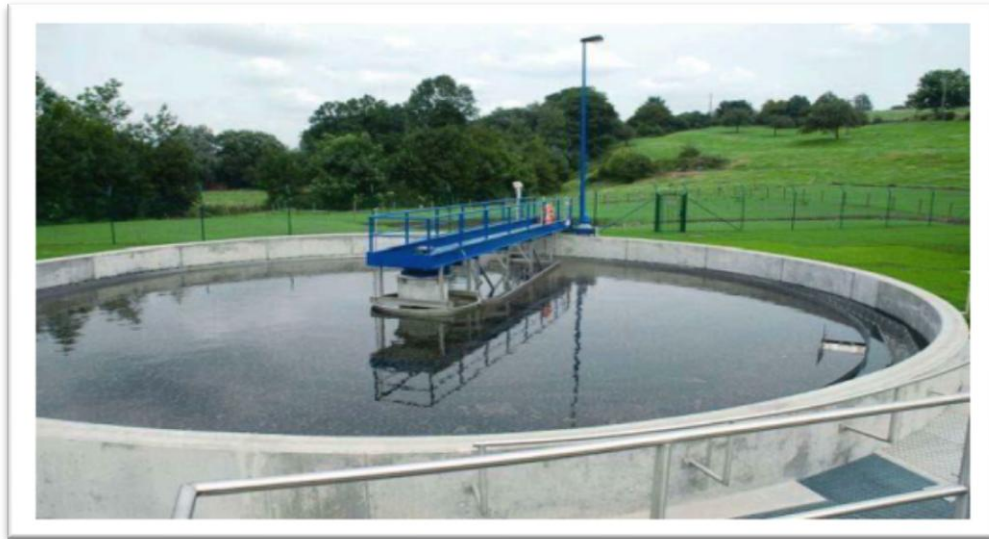
Figure II.5 : Décanteur secondaire (clarificateur).
