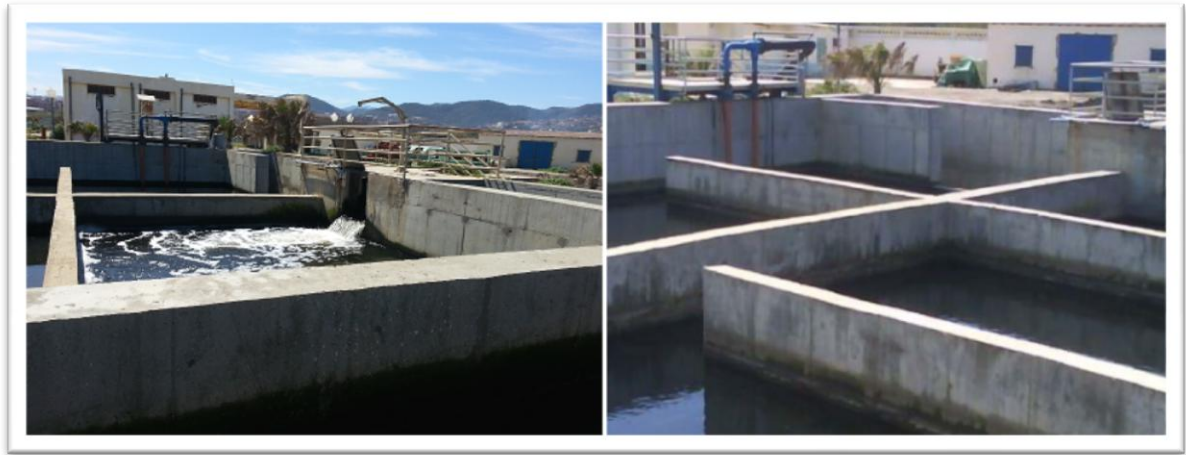
Figure IV.13 : Bassin de chloration.
