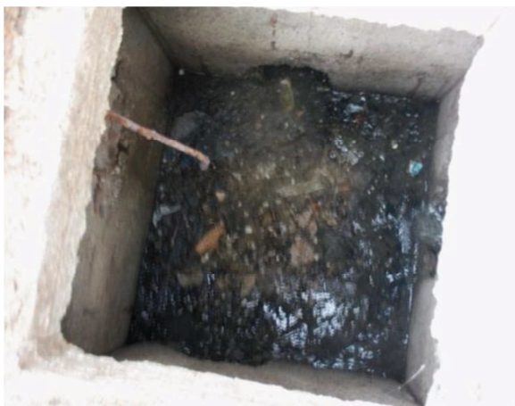
Photo II.01 : Regard en mauvais état (Entassement des résidus).
