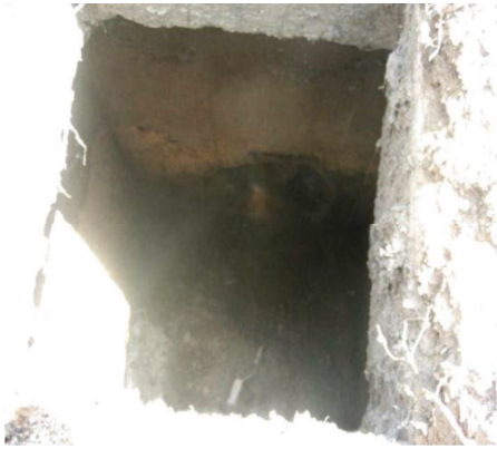
Photo II.03 : Regard en état dégradé.
