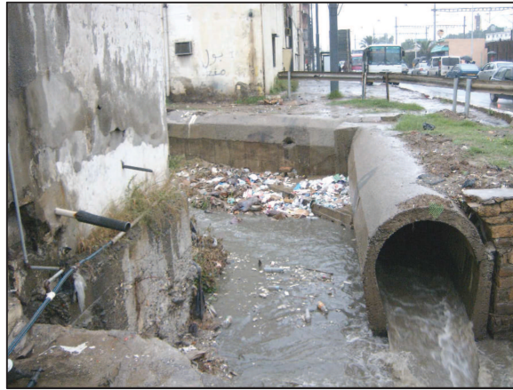
Photo II.07 : Premier rejet dans l'Oued Ochaiah.
