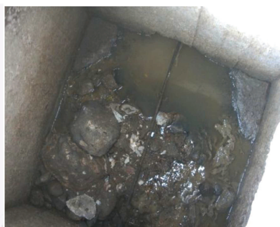
Photo II.02 : Regard complètement obturé.
