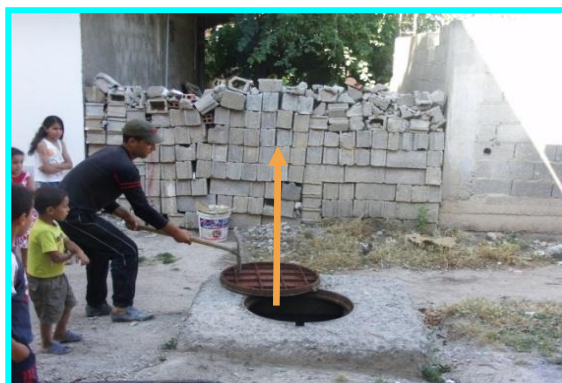
Photo III.04 : un autre tronçon passant sous le mur dans la cité El Kessyouné.
