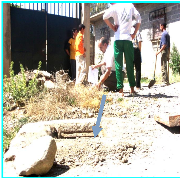
Photo III.02 : Collecteur sous la Construction Dans la cité El Djebass.
