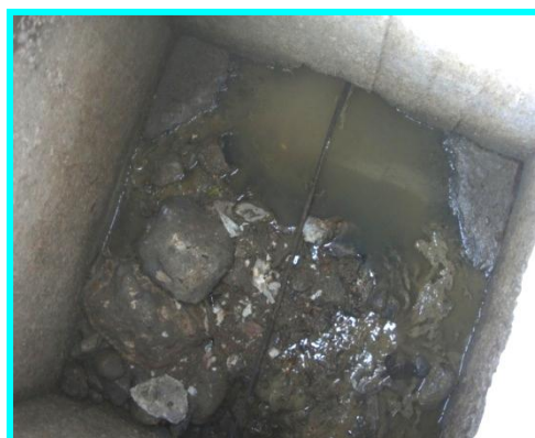
Photo III.06 : Regard complètement obturé.
