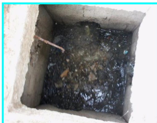
Photo III.05 : Regard en mauvais état (Entassement des résidus).
