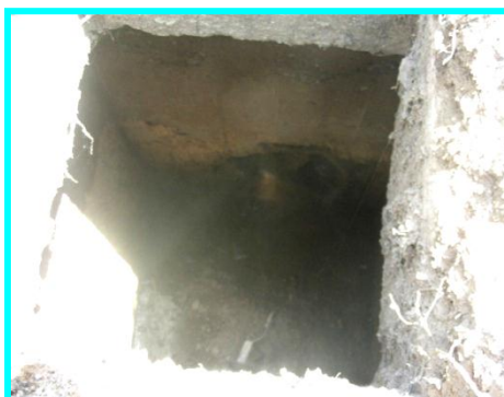
Photo III.08 : Regard en état dégradé.
