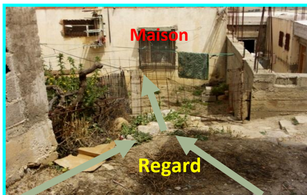
Photo III.03 : tronçon passe sous une maison dans la cité El Kessyouné
