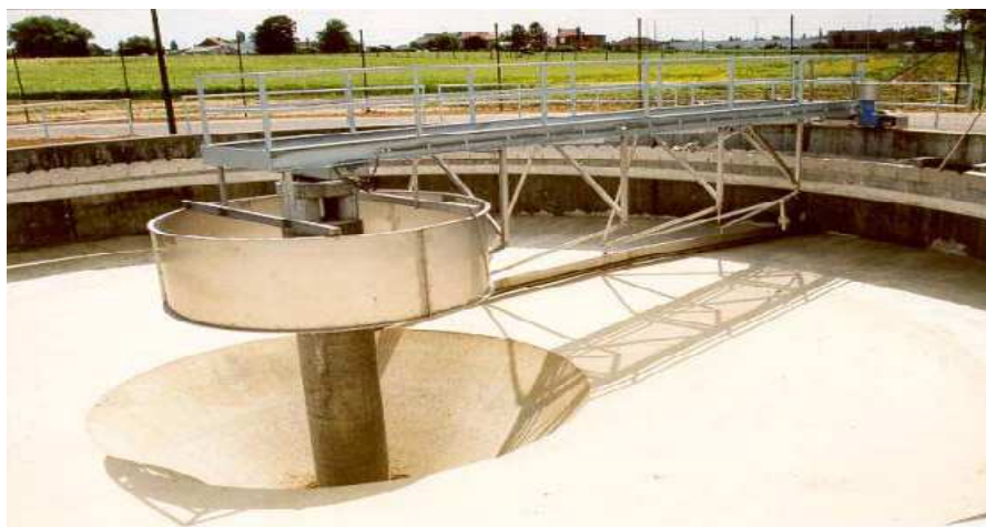
Figure 6 – Décanteur primaire avec pont racleur à entraînement périphérique
