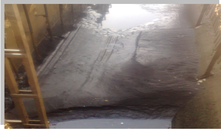
Figure 35 - Dépôts de sable au fond du bassin
