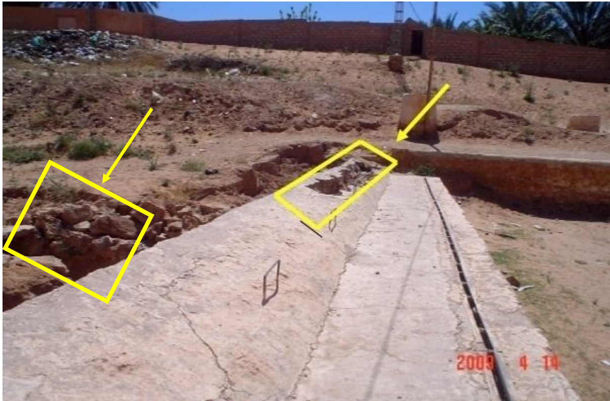
Photo II-19 : Rupture des Tissambads et des canaux souterrains
