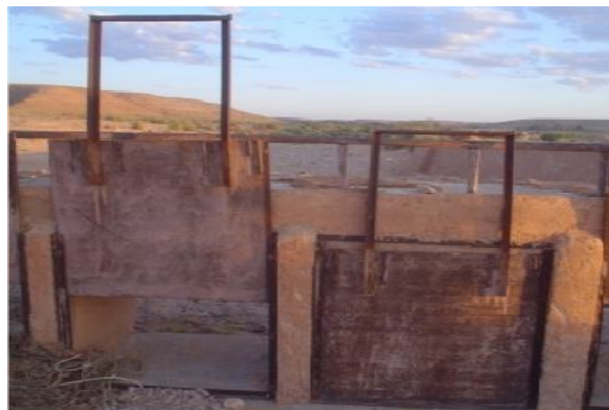
Photo II-2 : Vannes métallique de régularisation de débit
