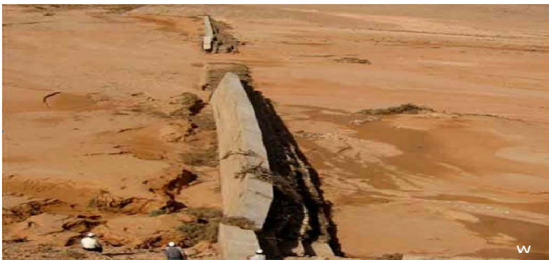
Photo II-18 : Destruction du barrage El Haimour par la crue de 2008 ( Bouach, 2011 )
