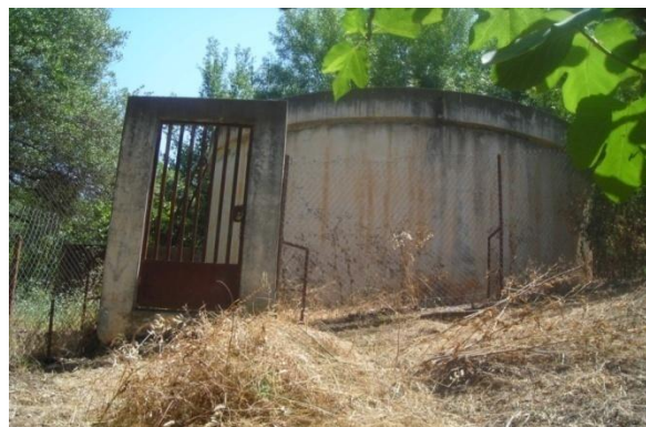
Figure III-8 : Réservoir 75m 3 d'Ighil Mimoune
