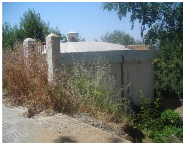
Figure III-11 : Réservoir 300 m 3 Tamaghoucht
