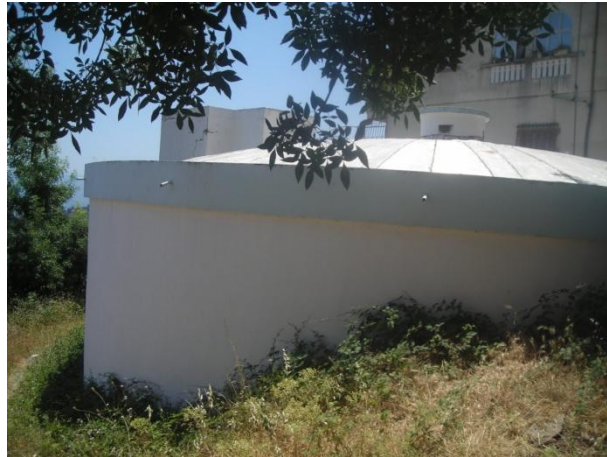
Figure III-6 : Réservoir 500 m 3 Ait Bouyahia
