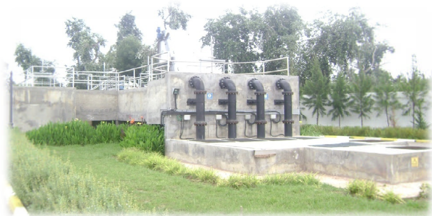
Figure IV.2 : Le poste de relevage
