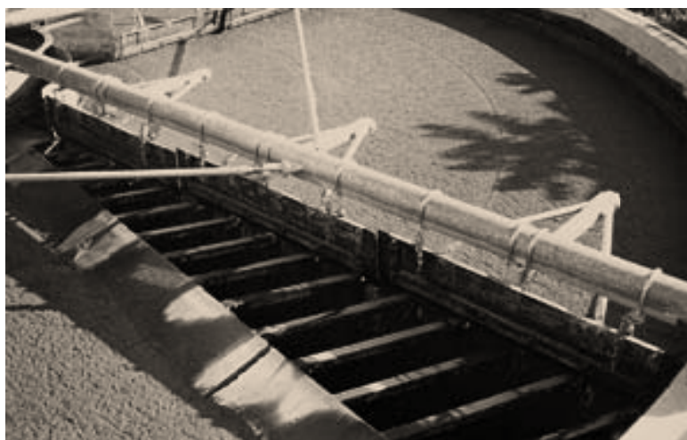
Figure 3: Épaissement des boues par flottation
