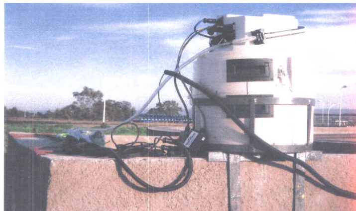
Photo 7 : Installation du préleveur N°1 au niveau d'ouvrage de sortie de décanteur secondaire (25 Février 2006)
