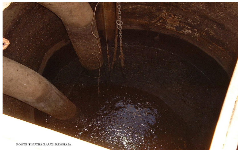
Figure 12 : Poste toutes eaux -réghaia
