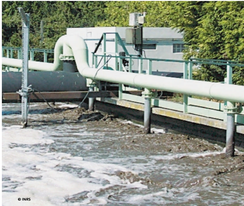
Figure 1 : bassin de traitement biologique
