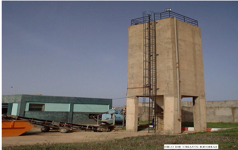
Figure 11 : Silo des chaux réghaia
