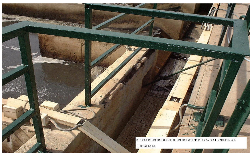
Figure 3 : dessableur déshuileur bout du canal central –réghaia
