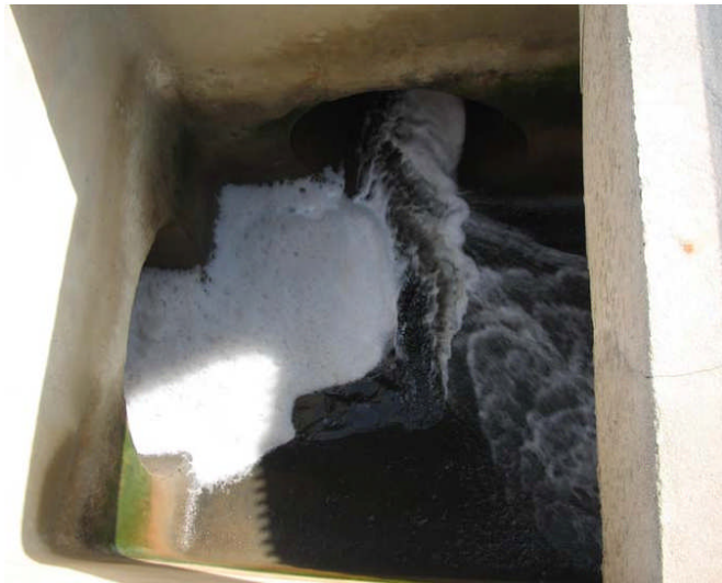
Photo 2 - Puisard de sortie où nous localiserons le flexible d'aspiration des eaux.
