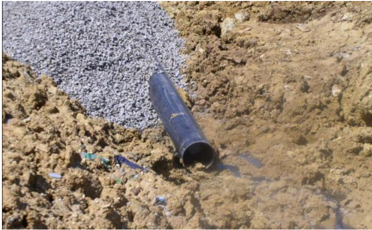
Figure V- 9 : conduite de drainage des lixiviats.
