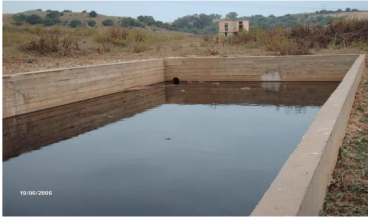
Figure V- 11 : le bassin de décantation de lixiviats.
