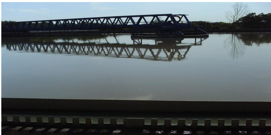
Figure 9 : décanteur primaire de la station de Réghaia
