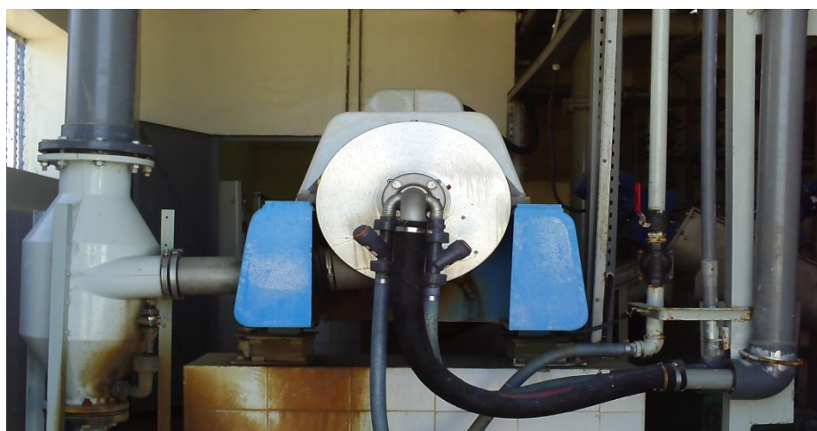
Figure 14 : Centrifugeuse pour la déshydratation des boues
