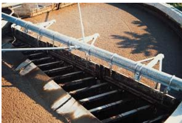
Figure 5 : Épaississement des boues par flottation
