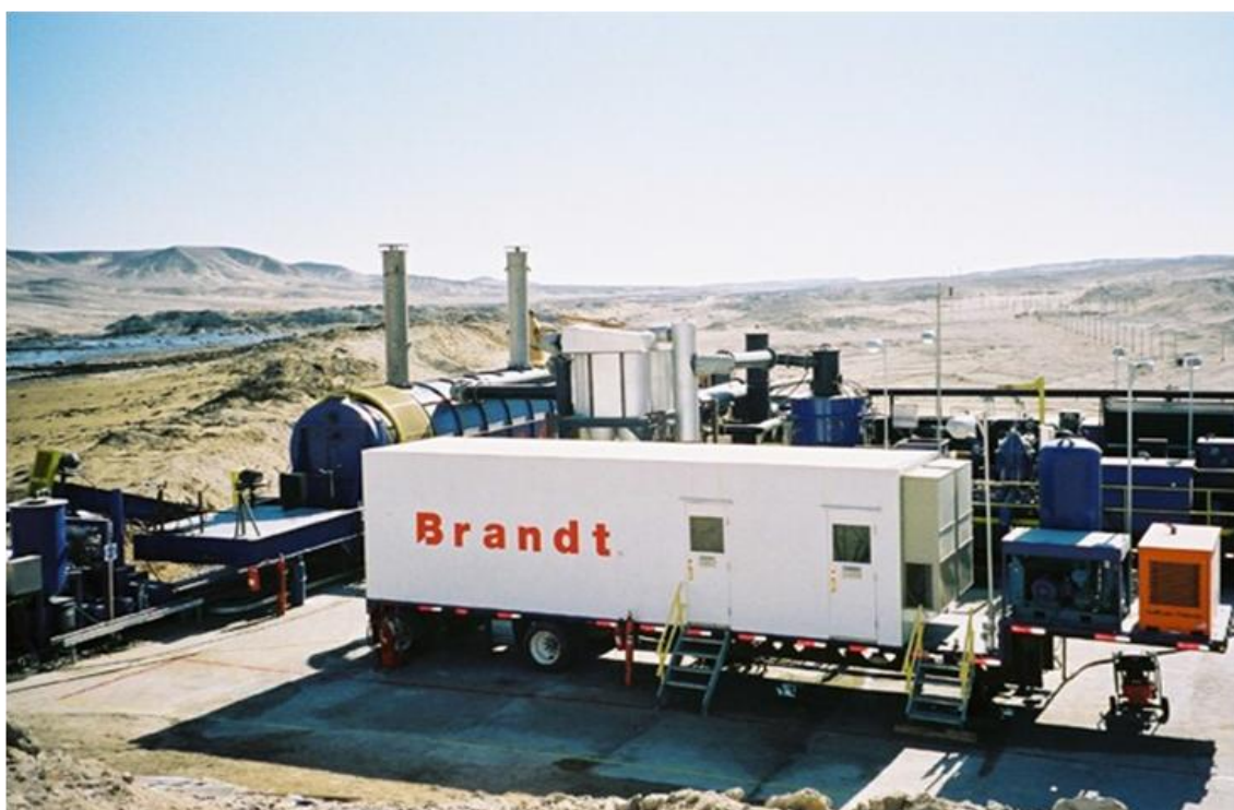
Figure (3-3) Unité de traitement thermique (TDU) à Hassi Messaoud
