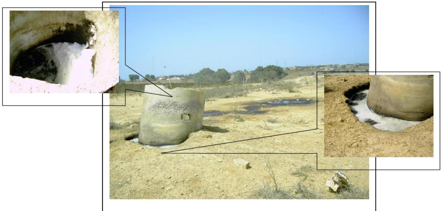
Figure VI-16 : Refoulement de lixiviats vers l'extérieur au niveau du cheminé de récupération des Biogaz du Casier N° 1, Ouled Fayet
