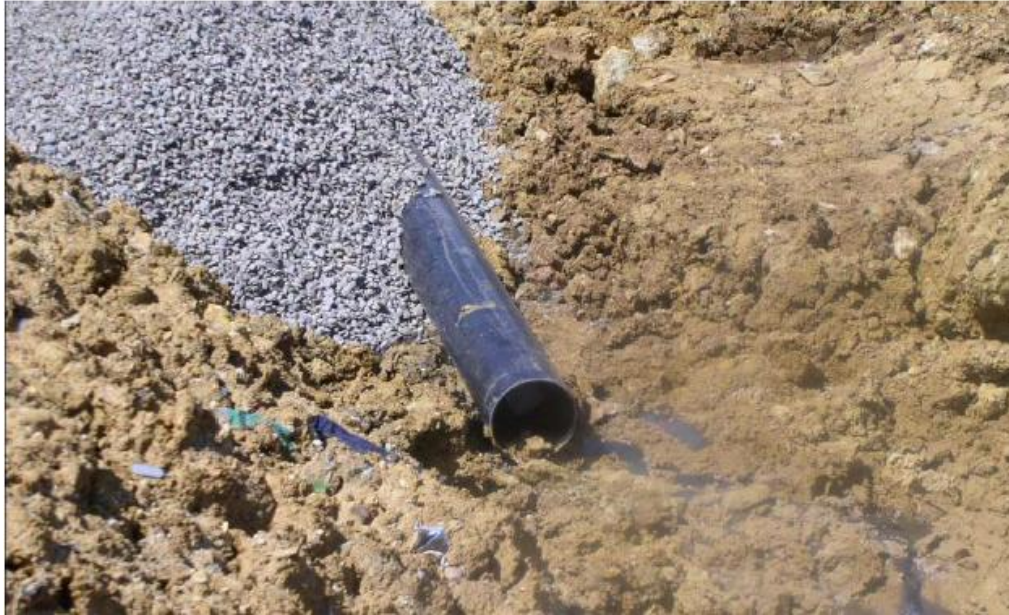
Figure VI-11 : conduite de drainage des lixiviats.
