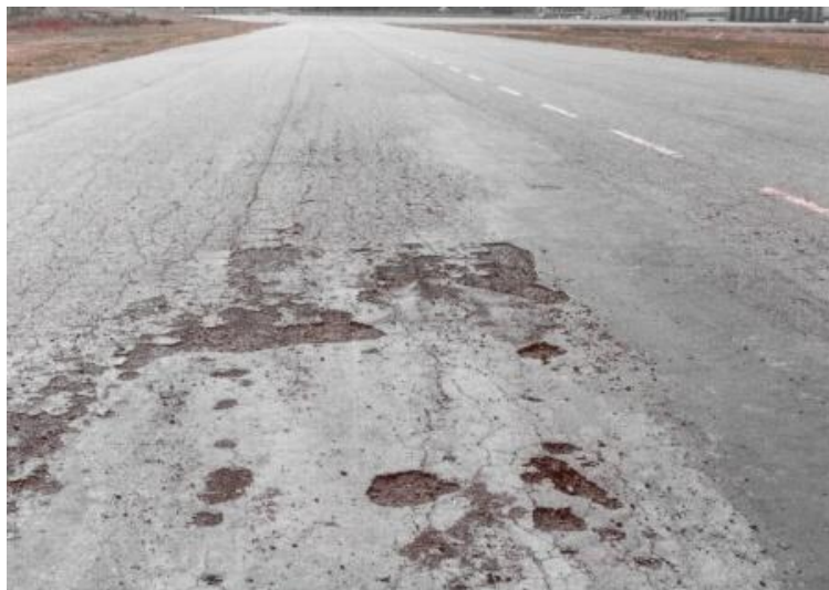
Figure I.11. Arrachement ou Déchaussement
