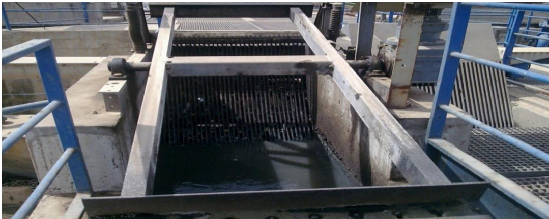
Figure I.3 : dègrilleur de la STEP de Boumerdes
