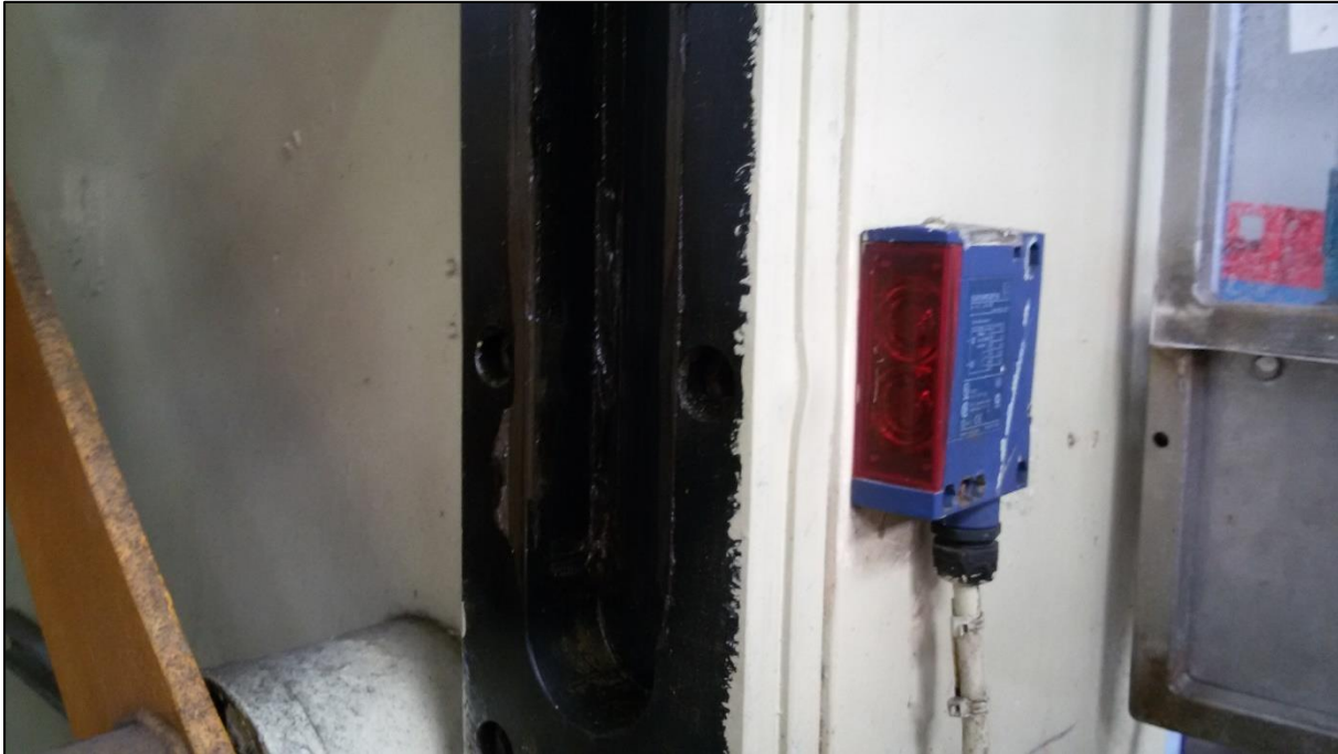
Photocellule à l'intérieur de la machine
