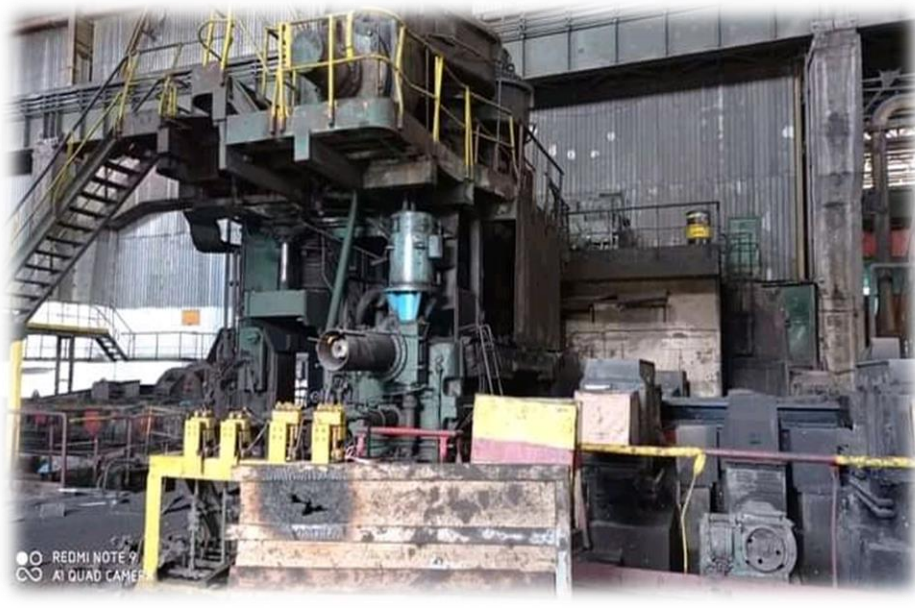
Figure I.2.13 : Photo d'une brise oxyde
