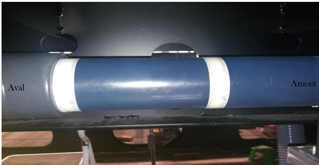
Figure A. 9: étiquettes graduées sur le collecteur principal du réseau d'assainissement
