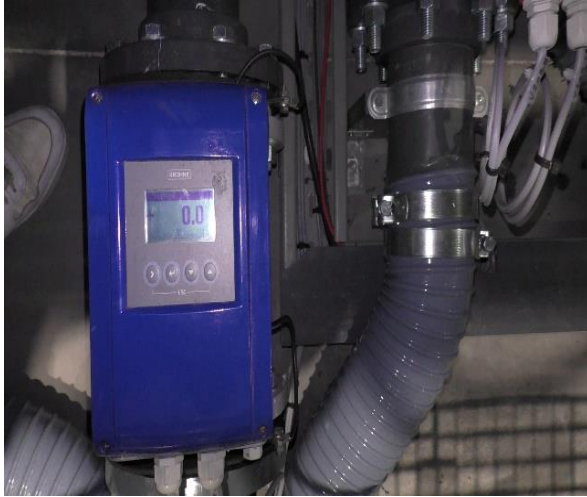
Figure III. 10 : lecteur installé sur un débitmètre électromagnétique
