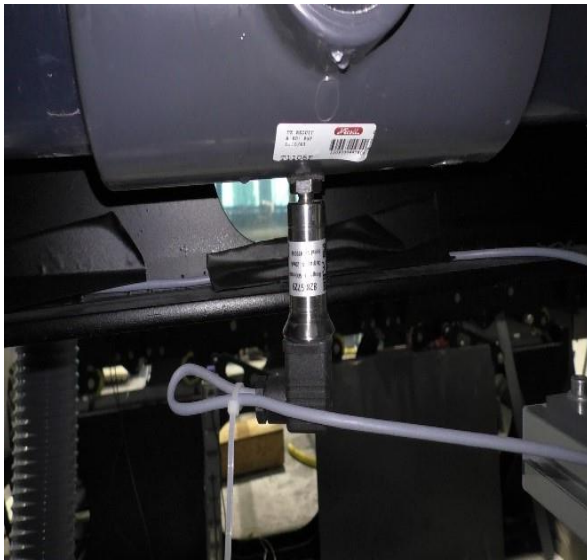
Figure III.9 : sonde de pression à l'amont du collecteur
