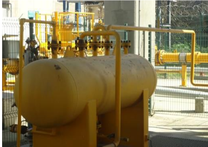
Figure 2.2: Réservoir à condensats.
