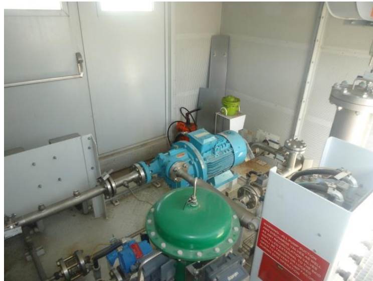
Figure 1.9: Pompe d'injection d'eau déminéralisée.
