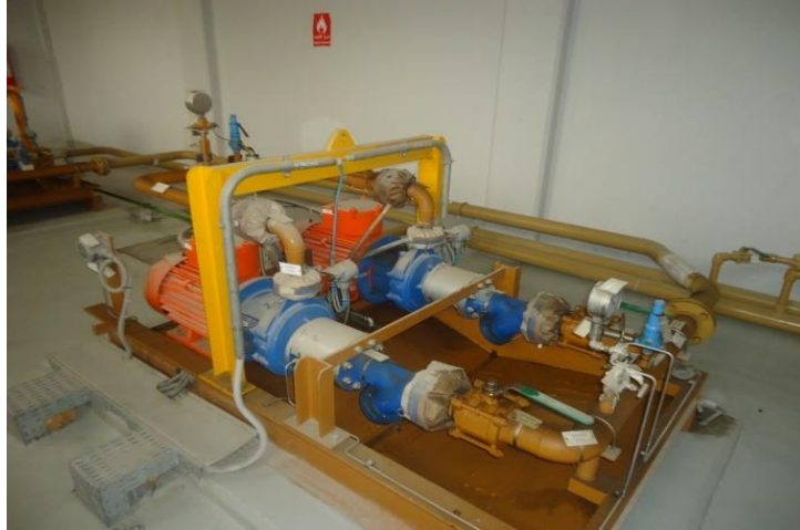
Figure 1.7 : Pompe de fuel
