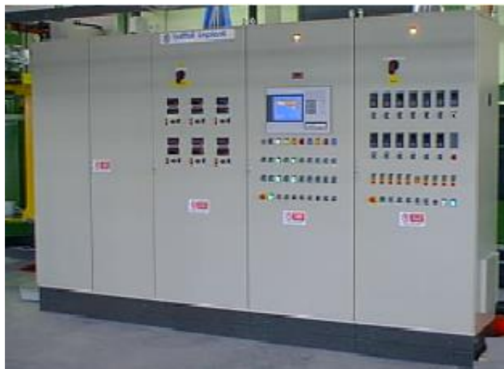
Figure 15 : Armoire de commande automatique
