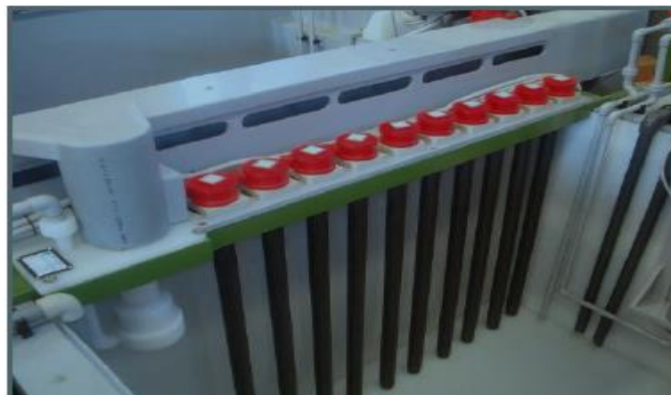
Figure 12 : Cuve dotée de système de chauffage
