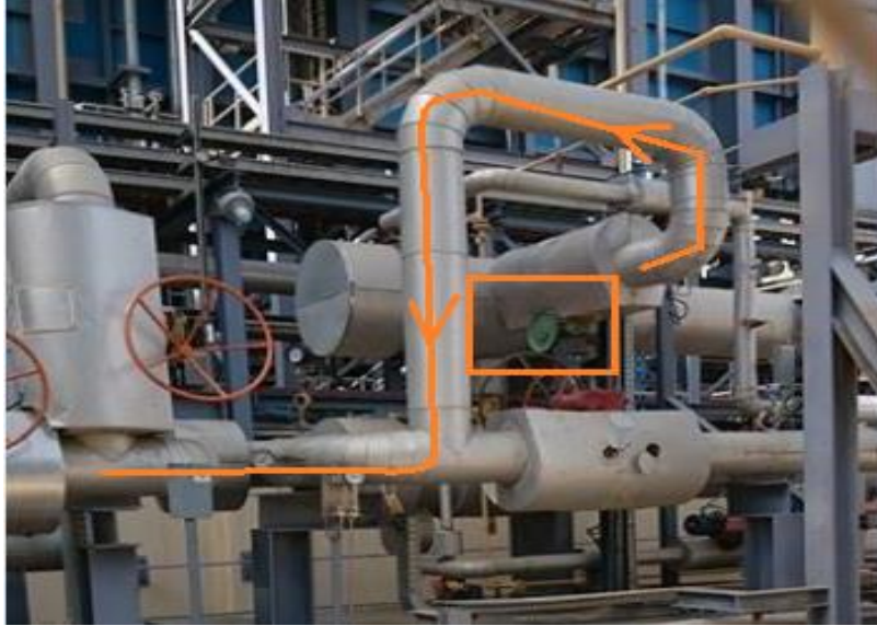
Figure 3-17 : Vanne manuelle de réglage de pression (sortie échangeur).
