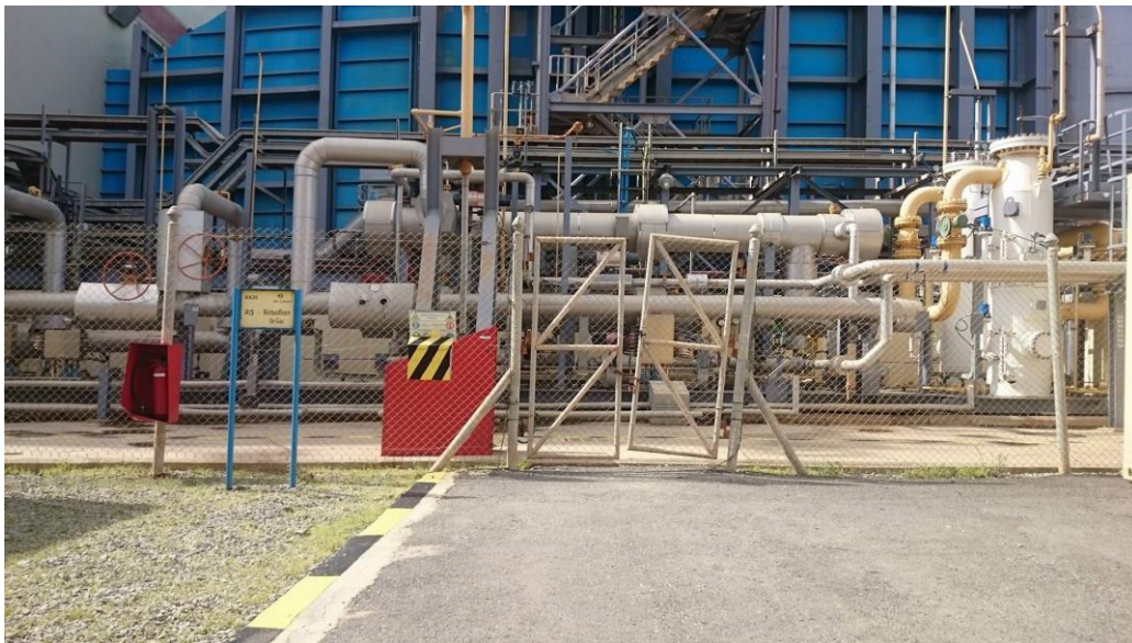
Figure 3-7 : Poste d'épuration et de réchauffement du gaz.
