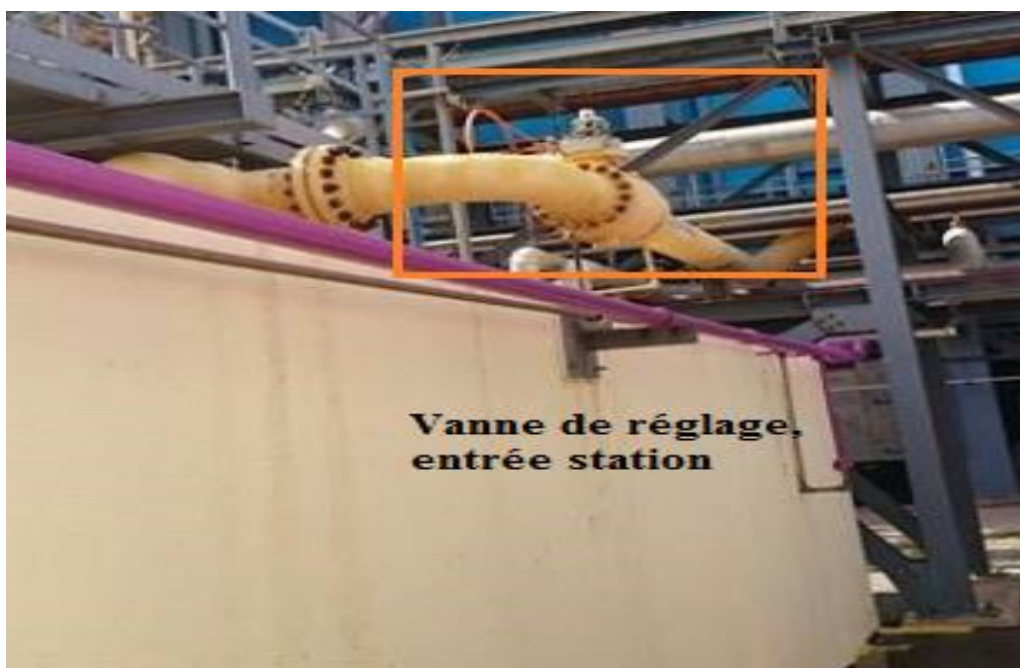
Figure 3-18 : Vanne manuelle à l'entrée à la station.
