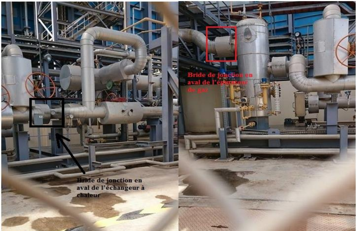
Figure 5-16 : Positionnement des SIS (brides de jonction en aval de l'échangeur à chaleur et de l'épurateur de gaz).
