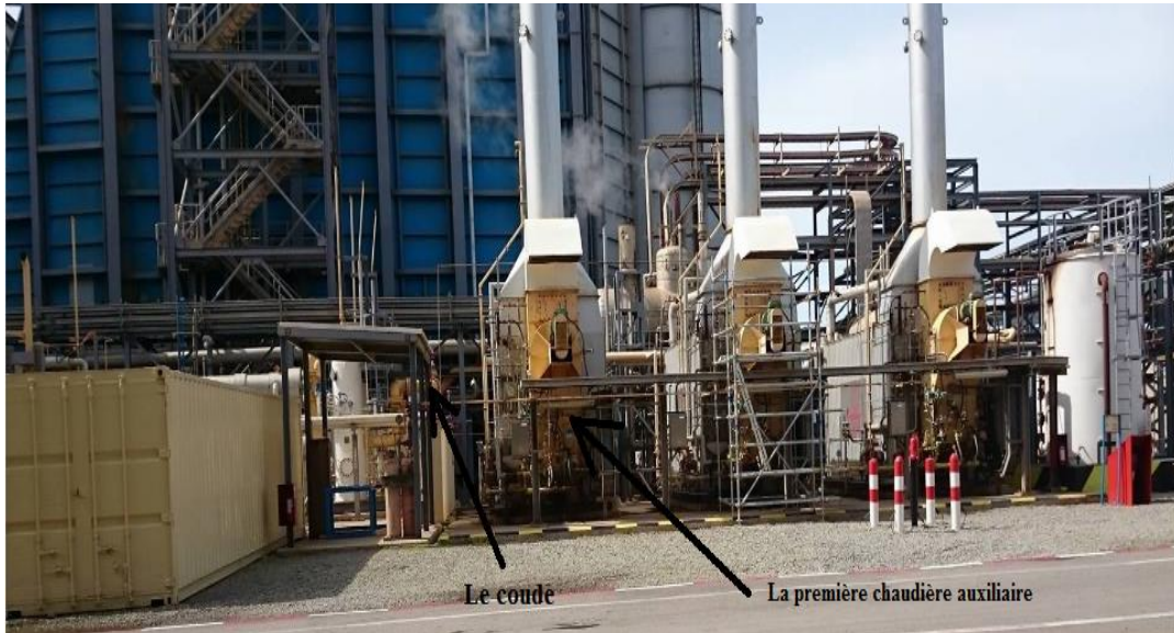
Figure 4-24 : Position du coude par rapport aux chaudières auxiliaires.
