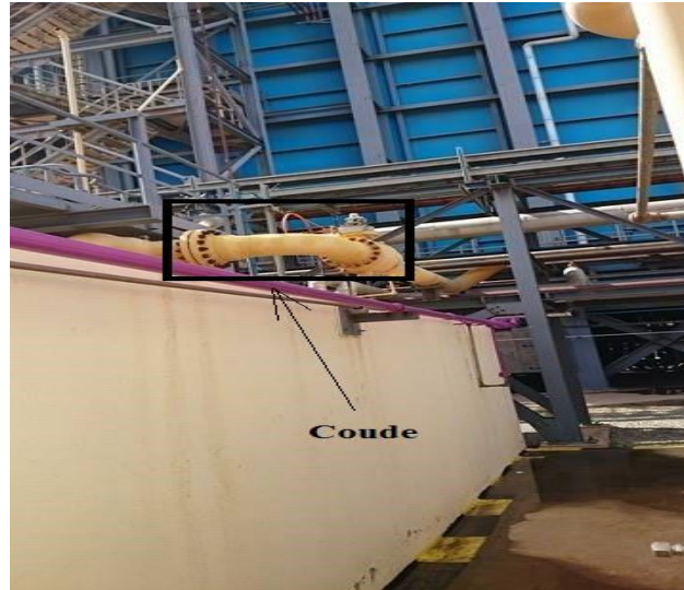
Figure 4-22 : Le coude dans la conduite gaz à l'entrée de la station de réchauffement et d'épuration.
