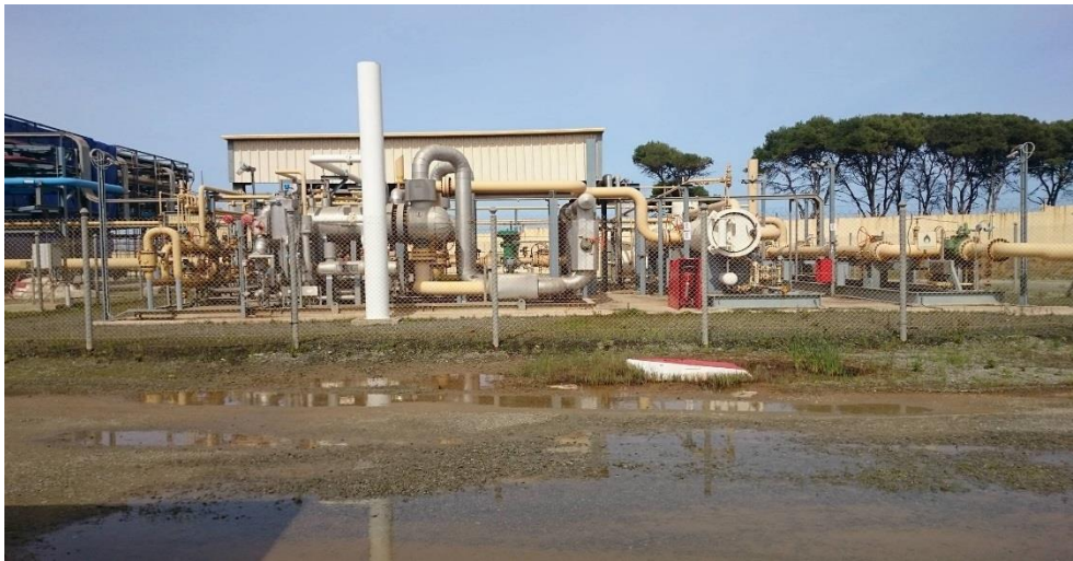
Figure 3-3 : Station de comptage et de détente principale du gaz.
