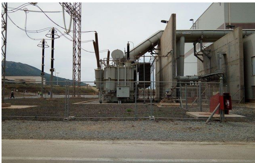
Figure 3-6 : Poste de Transformation et de départ.
