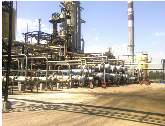
FIGURE 3.4 – Train de préchauffe (batterie d'échangeurs)
