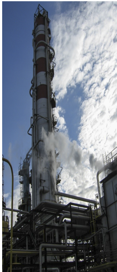
FIGURE 3.7 – Colonne de distillation atmosphérique
