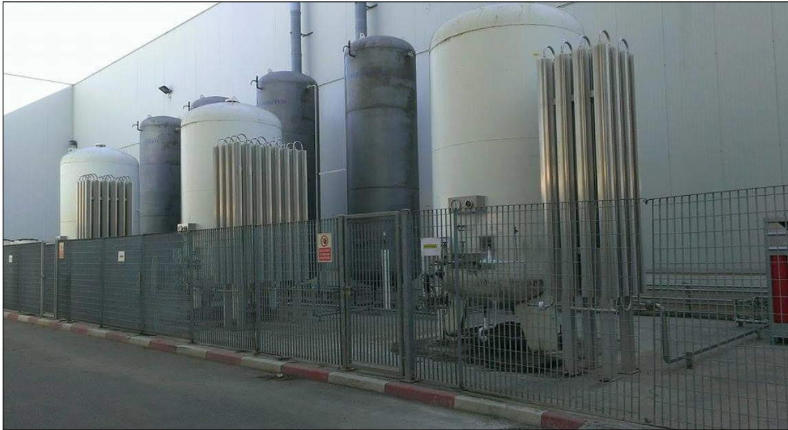
Figure 1-6 : Zone de stockage des liquides/Gaz.
