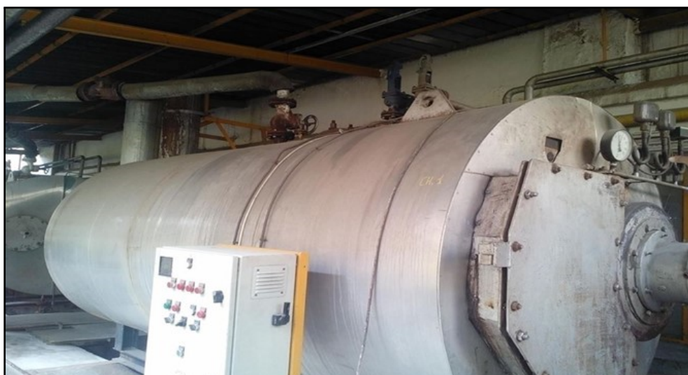
FIGURE 3.11 – Chaudière à vapeur de [Source exclusive]
