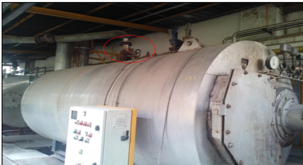
FIGURE 3.20 – Vanne de sureté de la chaudière à vapeur[Source exclusive]
