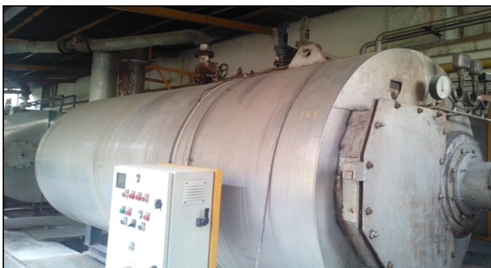
FIGURE 3.5 – Chaudières à vapeur [Source exclusive]
