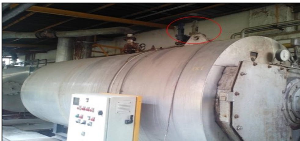
FIGURE 3.19 – Soupapes de la chaudière à vapeur [Source exclusive]
