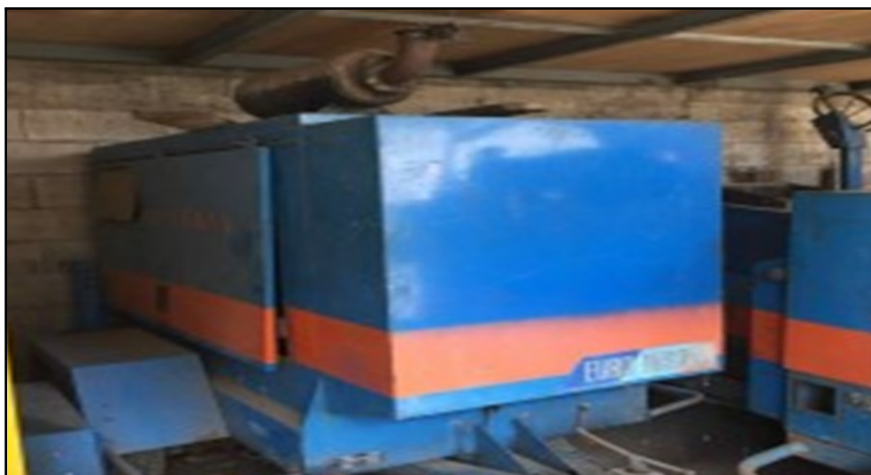
FIGURE 3.3 – Groupe électrogène de secours [Source exclusive]
