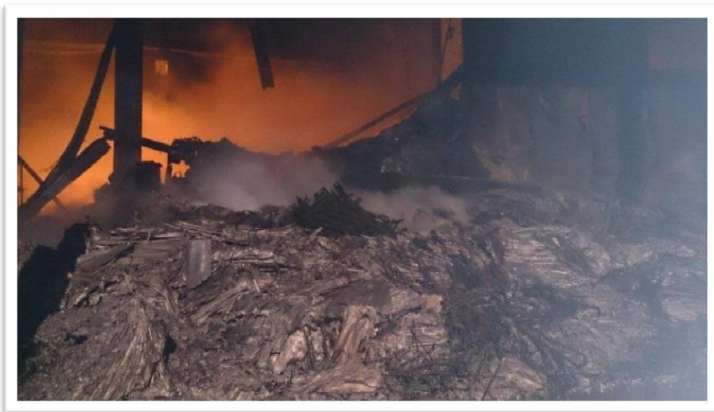
Figure 1.12 : Aperçu de l'importance des dégâts matériels causés par l'incendie de l'usine de Samsung à Sétif (Source : http://www.setif.info/article8795.html )
