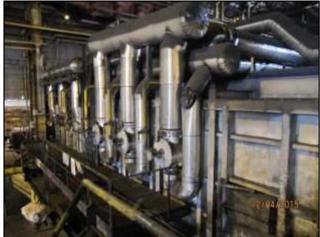
Figure 3-5 : Vue latérale gauche des brûleurs de la zone I et II (source exclusive)
