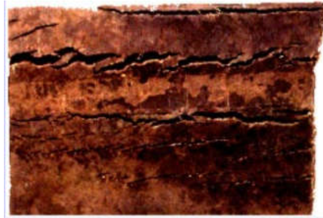
Figure 1.12: Exemple de la corrosion sous contrainte
