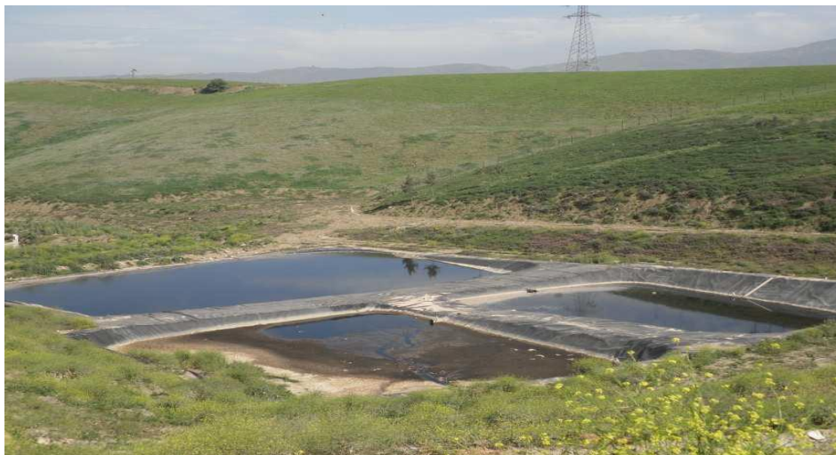
Figure 2.4 : Bassin de rétention de lixiviats.(EPIC CODEM)
