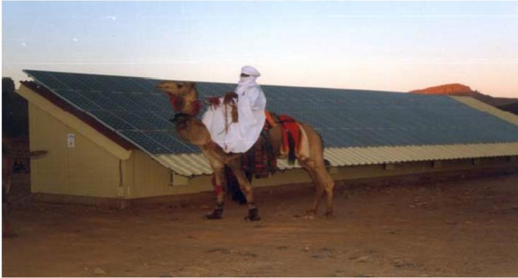
Figure 2. 1 : Système photovoltaïque de puissance 6kWc installé au village isolé de Terhenanet wilaya de Tamanrasset [29].
