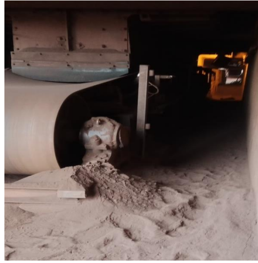
Figure 30 : Poussière de déchargement Intérieur
