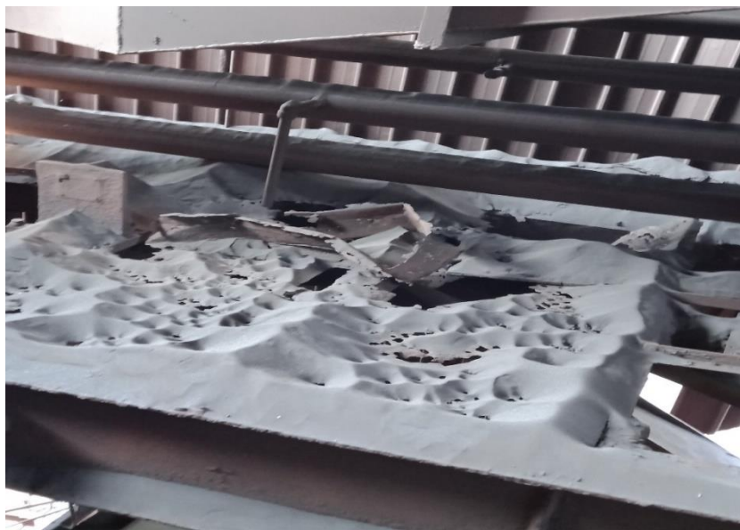
Figure 26 : L'effet de la poussière sur les toitures
