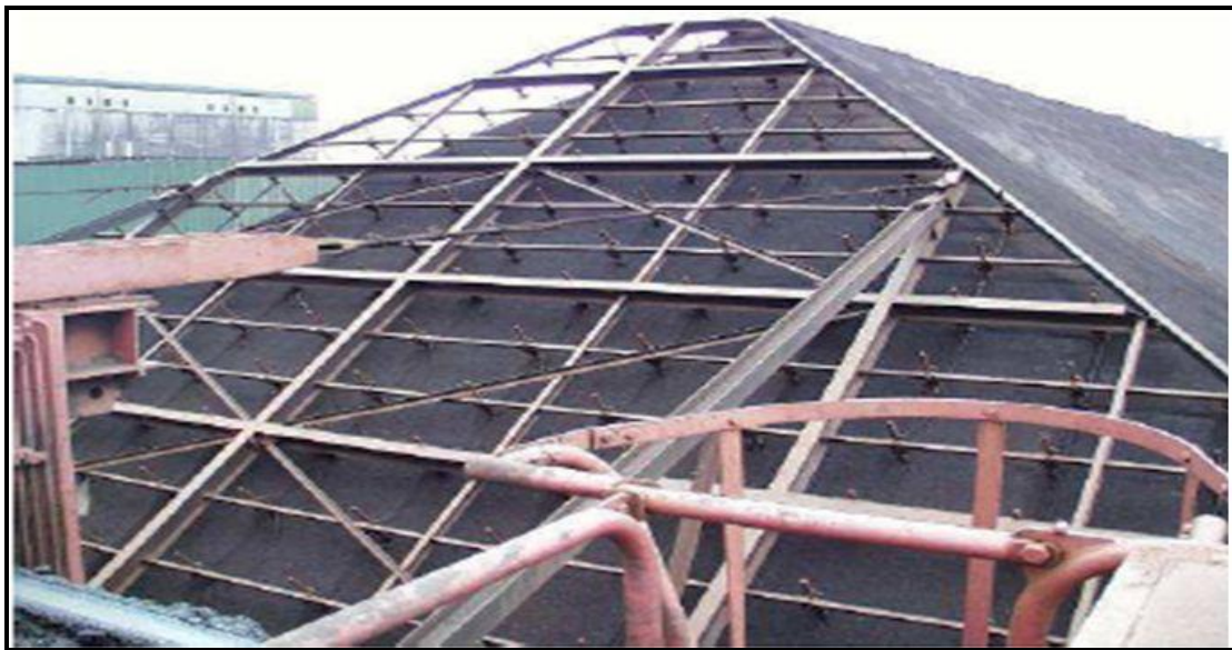
Figure 5 : Herze servant à homogénéiser les différentes couches
