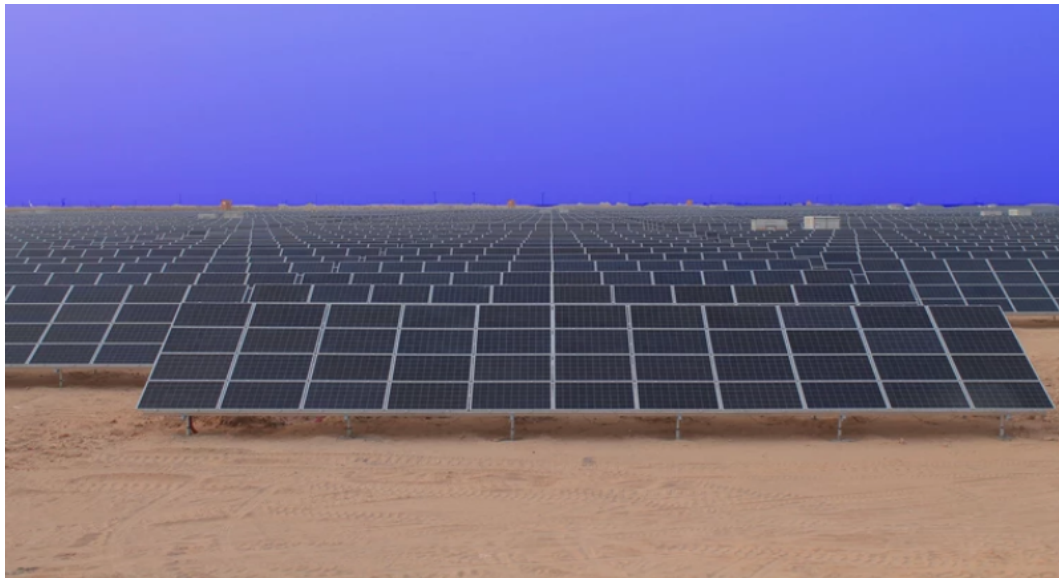
FIG. 4.12 : La centrale solaire (photovoltaïque) de 20MW d'Adrar
