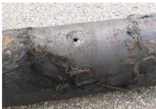
FIGURE 2.5 – Photo réelle de corrosion par effet de courant vagabonds [51]
