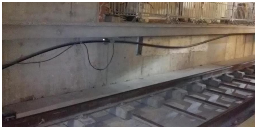
FIGURE 2.9 – Photo réelle du feeder [14]
