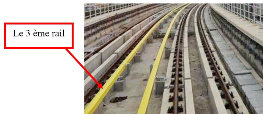
FIGURE 1.9- Alimentation par 3 ème rail [16]
