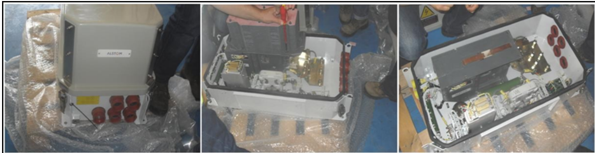
FIGURE 2.14 – Coffre disjoncteur principal.
