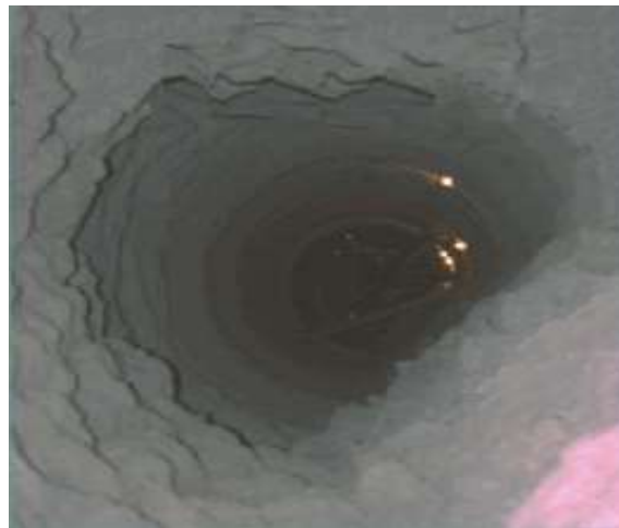
Figure IV- 5 : Croûtage dans le four [1]
