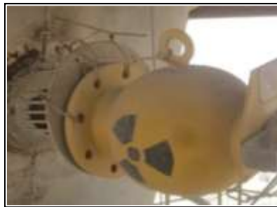
Figure IV- 2 : Emplacement de la Sonde gamma sur le cyclone [1]
