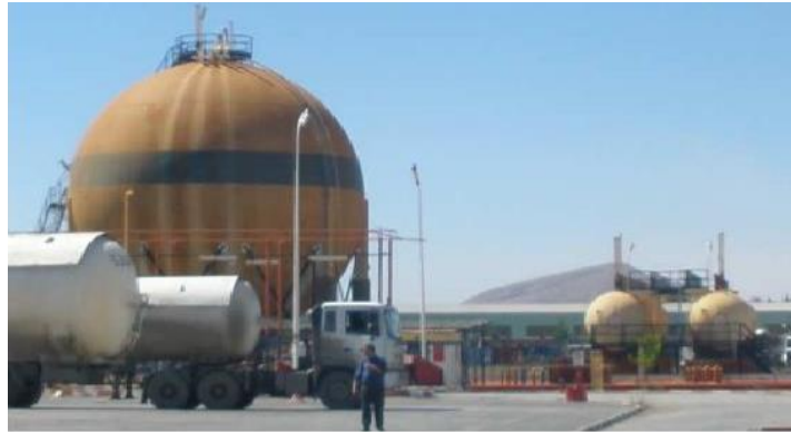
Figure 21 : Photo réelle des équipements de stockage GPL du centre 191
