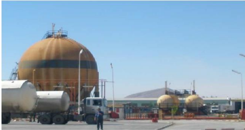
Figure 12: photo de la Sphère du butane et les cigares du propane
